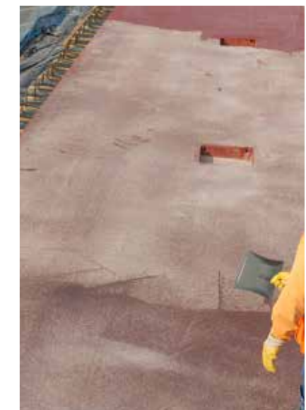
Absanden der Oberfläche
