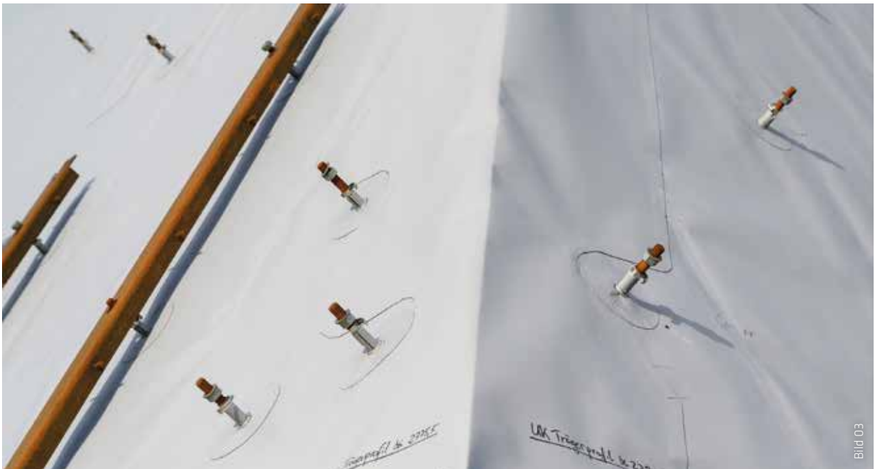
Die Gewindebolzen sind mit vorgefertigten Sarnafil-Pfosteneinfassungen abgedichtet. In die darauf verschraubten Stahlträger werden später die Cortenstahlplatten eingehängt.
