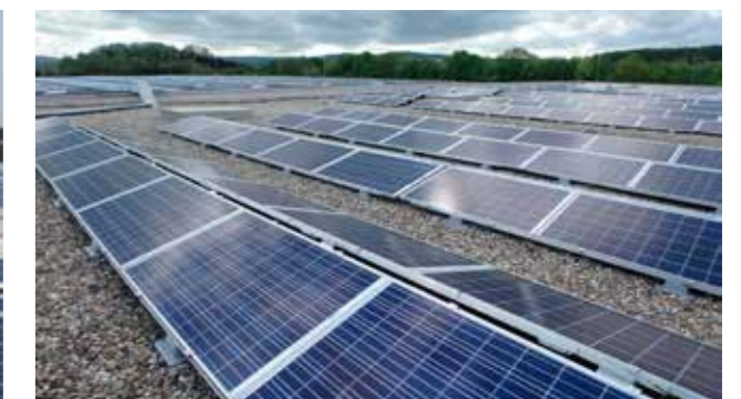
Ost-West Ausrichtung der Module
