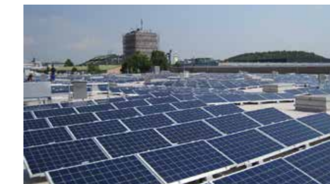
Süd Ausrichtung der Module
