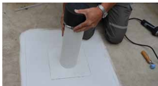
Fertig montiertes RCS-Rohr
