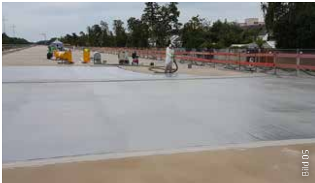
Die Grundierung der Fläche erfolgte in zwei Arbeitsgängen mit Sikagard®-186, einem Grundierharz gemäß ZTV-ING für Betonfahrbahntafeln im Brückenbau und Ingenieurbauwerken. Anschließend streuten die Verarbeiter die Fläche im noch frischen Zustand mit Quarzsand ab.
