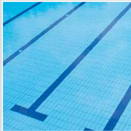
Hochbelastete Bereiche mit drückendem Wasser
