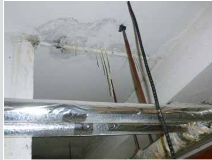
Kommunizierende Röhren führen ohne Kapillarverguss und Betonfugendichtband zu Feuchteschäden im Bereich der Beckenumgänge und darunter befindlicher Technikräume.
