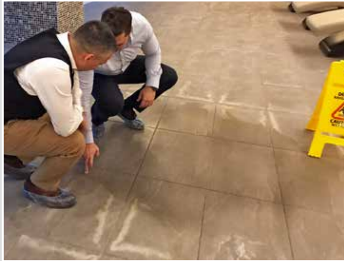
Feuchteschaden durch nicht vorhandenen Kapillarverguss.
