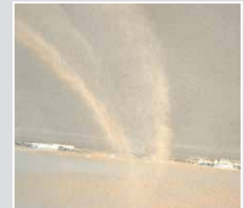
Die Fläche in der Frischphase des Material mit Quarzsand absanden und nach Trocknung absaugen/abkehren.
