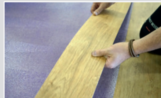
Dank der 2-stündigen Einlegezeit ist es möglich große Flächen in einem Zug zu bearbeiten.
