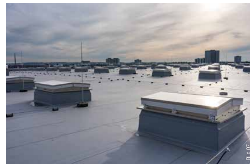
Bei den vorhandenen RWA und Lüftern wurde die Dachbahn am oberen Abschluss mit einem Verbundblech befestigt, die Abdichtung an der Aufkantung hochgeführt und mit dem Verbundblech thermisch verschweißt.
