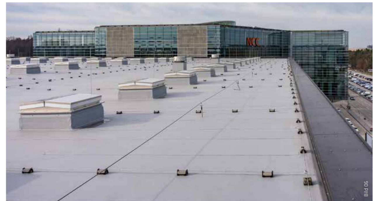
Auf dem 7.500 qm großen Dach der Halle 4A befinden sich insgesamt 98 Rauch- und Wärmeabzugsanlagen (RWA) und acht Lüfter.
