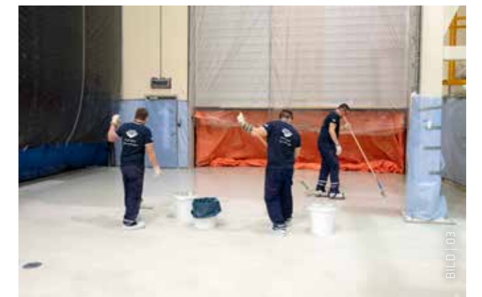
Versiegelung des neuen ESD-Bodensystems im ESTEC mit Sikafloor®-305 W ESD. Die harte Oberfläche hält den tonnenschweren Testanlagen der ESA stand.
