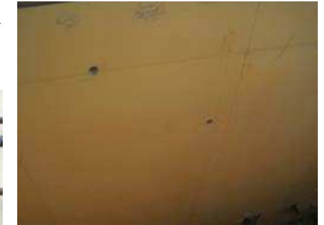
Durch kreisrundes Ausschneiden der Spannstellen kann eine Faltenbildung im Wandbereich minimiert werden.
