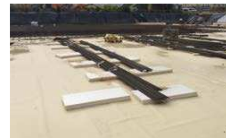
Schutzmaßnahme beim Lagern von Bewehrungsstahl
