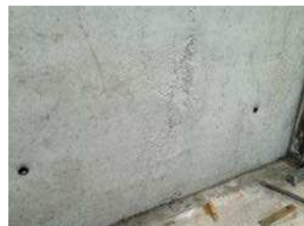
Flächige Lunker und Kiesnester müssen im Vorfeld saniert werden.
