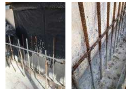
Die Schutzfolie hat ihren Zweck erfüllt (Bild links); Verschmutzungen sind zu vermeiden oder müssen umgehend im frischen Zustand gereinigt werden (Negativbeispiel, Bild rechts).
