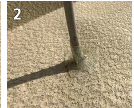
2 Übergangsbereich von Verbundschicht zu Fundamenterder wie auf Bild zu sehen mit SikaProof® Sandwich-tape andichten
