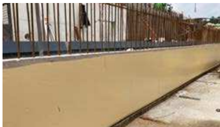
Aussparen von SikaProof® A+ im Fugenbereich für die spätere außenseitige Abdichtung mit dem Sikadur-Combiflex® TF System
