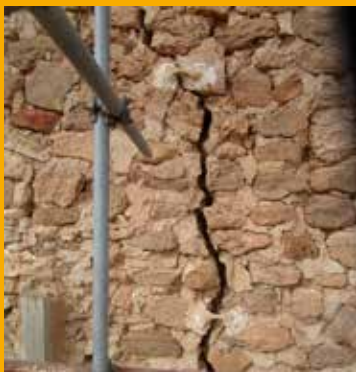
Riss im östlichen Segment der Nordwand des Westiwans (Foto: Burkert)
