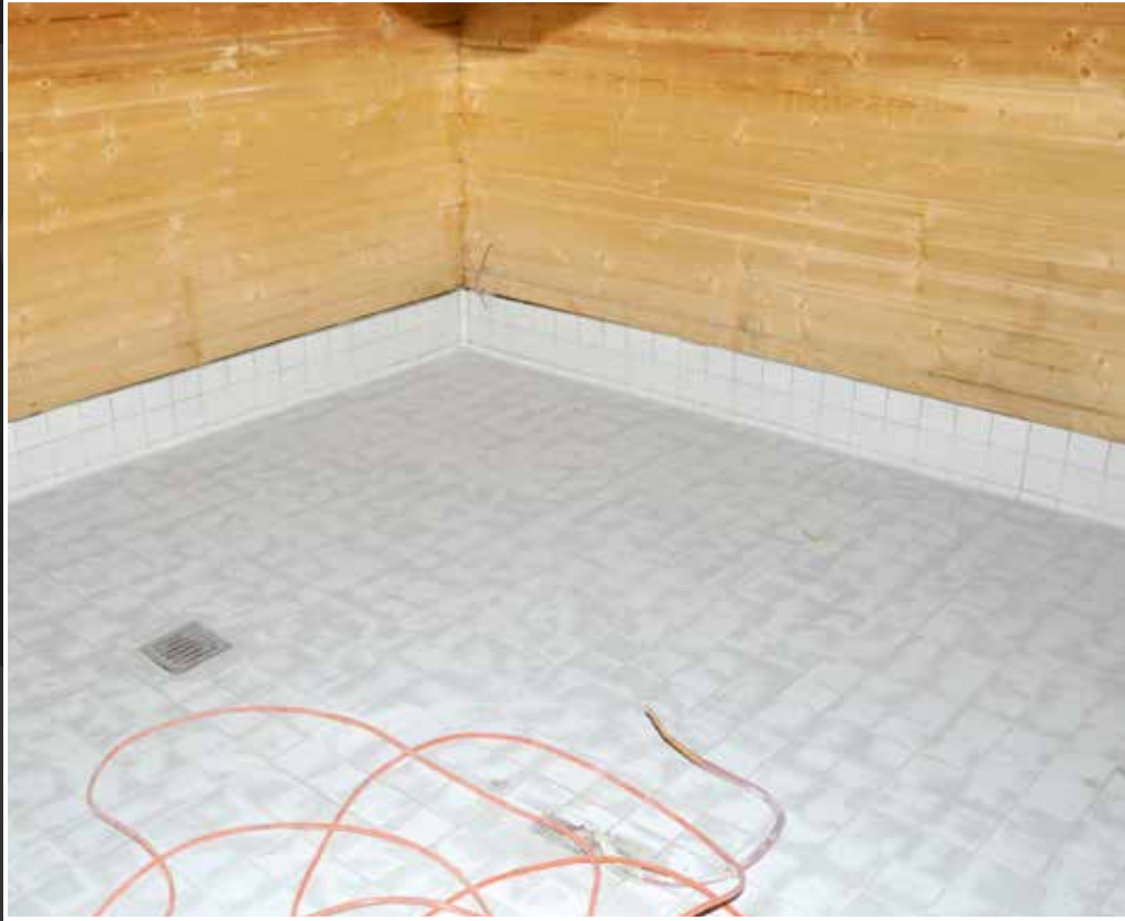
Angeschliffener Keramikaltbelag in der Sauna des Erdgeschossbereiches.
