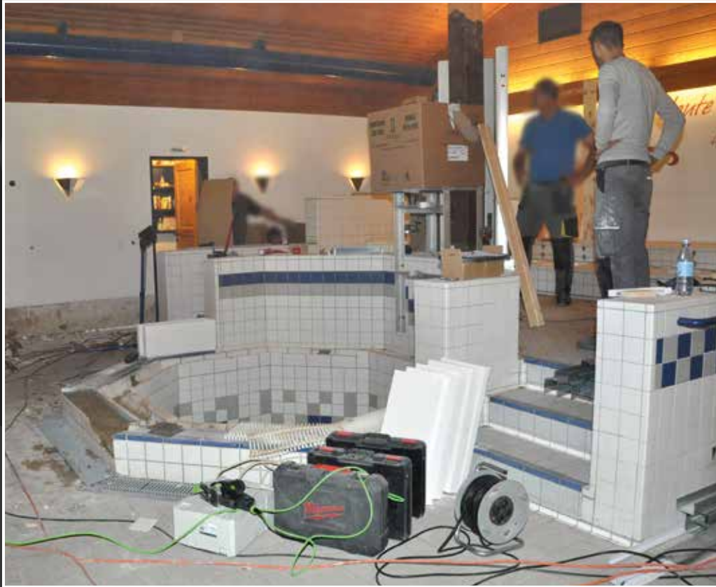
Tauchbecken vor der Sanierung.
