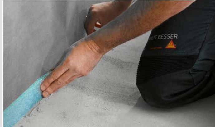
1 Vor Einbringen des Leichtestrichs den SCHÖNOX NIVELLIERRANDSTREIFEN zu allen aufgehenden Bauteilen aufstellen.
