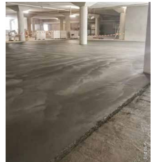
Frisch eingebautes Betonersatzsystem PCCI/RM mit den Komponenten Sikafloor® K&H 101, Sikafloor® ES-104/108+Additiv. Gut zu sehen ist die spätere Arbeitsfuge dieses Abschnitts.
