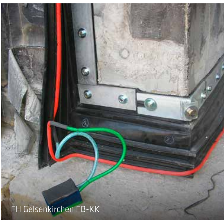
FB-KK Wasserwerk Coesfeld
