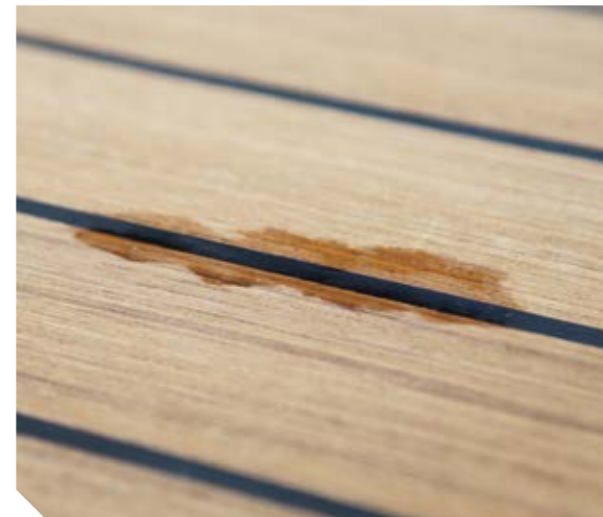
Beschädigtes Teakdeck durch Wassereintrich
