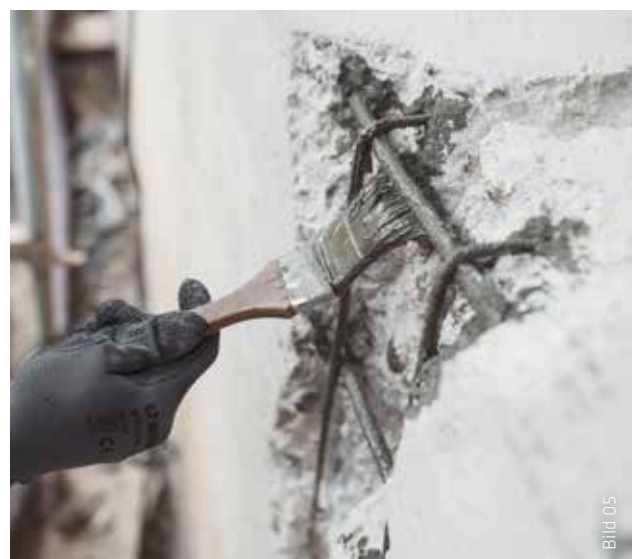
Der freigelegte, entrostete Bewehrungsstahl wird durch einen Anstrich mit Sika MonoTop®-601 NEU vor Korrosion geschützt.
