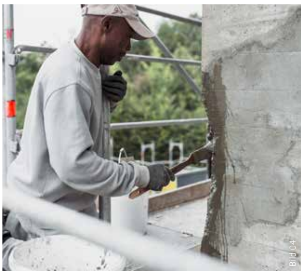
Die Haftbrücke Sika MonoTop®-602 NEU wird unter Druck in die mattfeuchten Ausbruchstellen eingebürstet.
