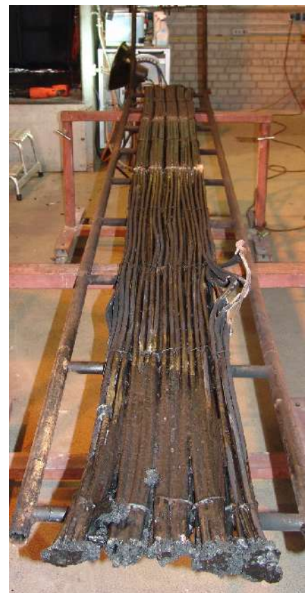
Bild 8: Schaden Vorderseite Figure 8: front side damage
