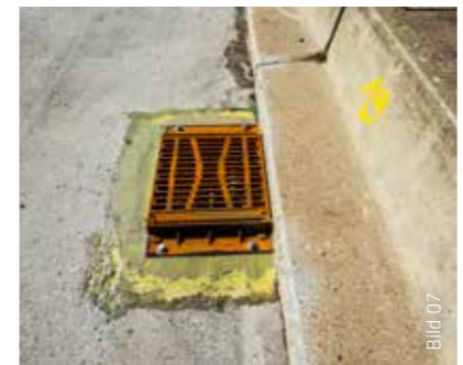
Um keine Überraschungen beim Einbau des in der Anfangsphase flüssigen Kunstharzes zu erleben, muss jede noch so kleine Fehlstelle abgedichtet werden: Hier die Sanieraufsätze der Einlaufschächte.
