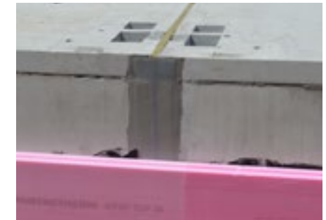
Anfüllschutz der Dehnfugenabklebung durch Perimeterdämmung
