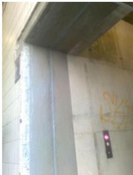
Sanierung einer Dehnfuge – hier ist abschließend eine Unterstützungskonstruktion durch eine Schleppblechverwahrung anzuordnen.
