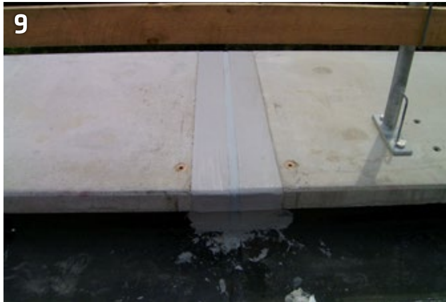
LFT-Fugenbandprofil in Sichtqualität im Bereich einer Brückenkappe
