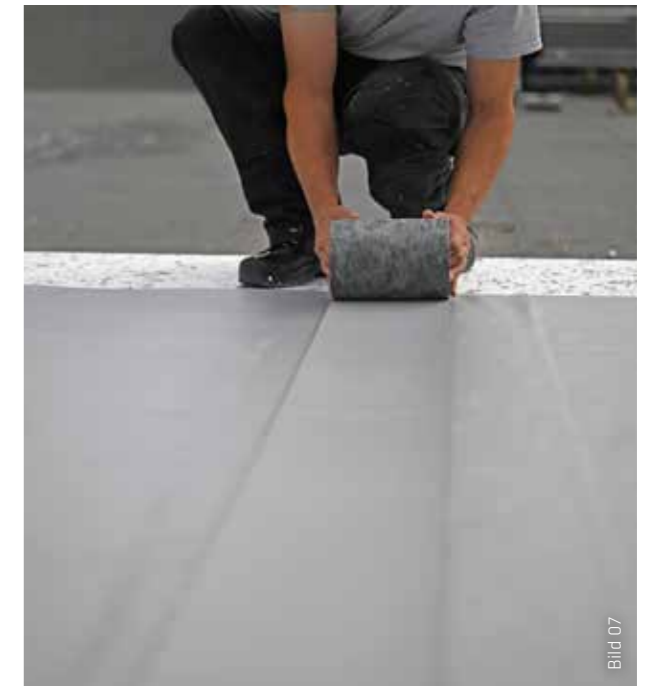
Es wurde von First zu Traufe verlegt, deshalb wurde ein 20 cm breiter Abdeckungsstreifen Sarnafil® AT-18 über die Bahnanschlüsse geschweißt.
