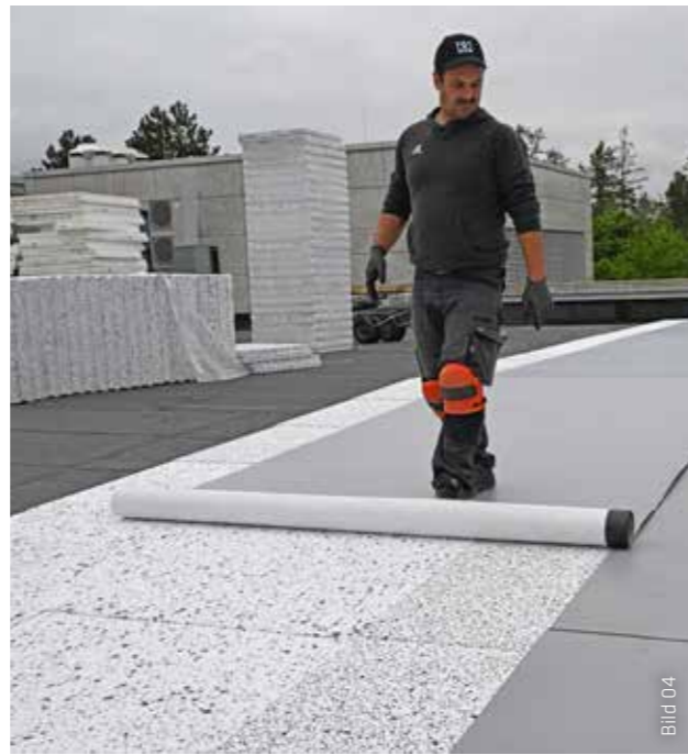
Auf die EPS-Dämmung wurde die selbstklebende Dachbahn Sarnafil® AT-18 FSA ausgerollt und ausgerichtet.
