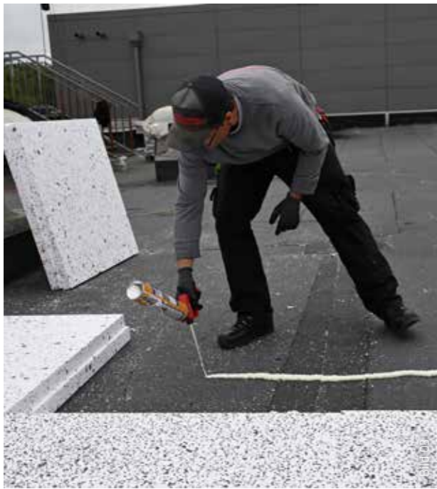
Die 120 mm starke EPS-Dämmung wurde mit dem PU-Klebschaum SikaRoof® Board Adhesive auf die neu verlegte Bitumendampfsperre aufgeklebt.
