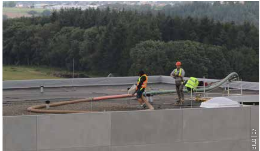
Auflasten wie die Kiesschüttung im Leitz-Park Wetzlar können bei der Aufbringung zu unbemerkten Beschädigungen der Dachabdichtung führen.
