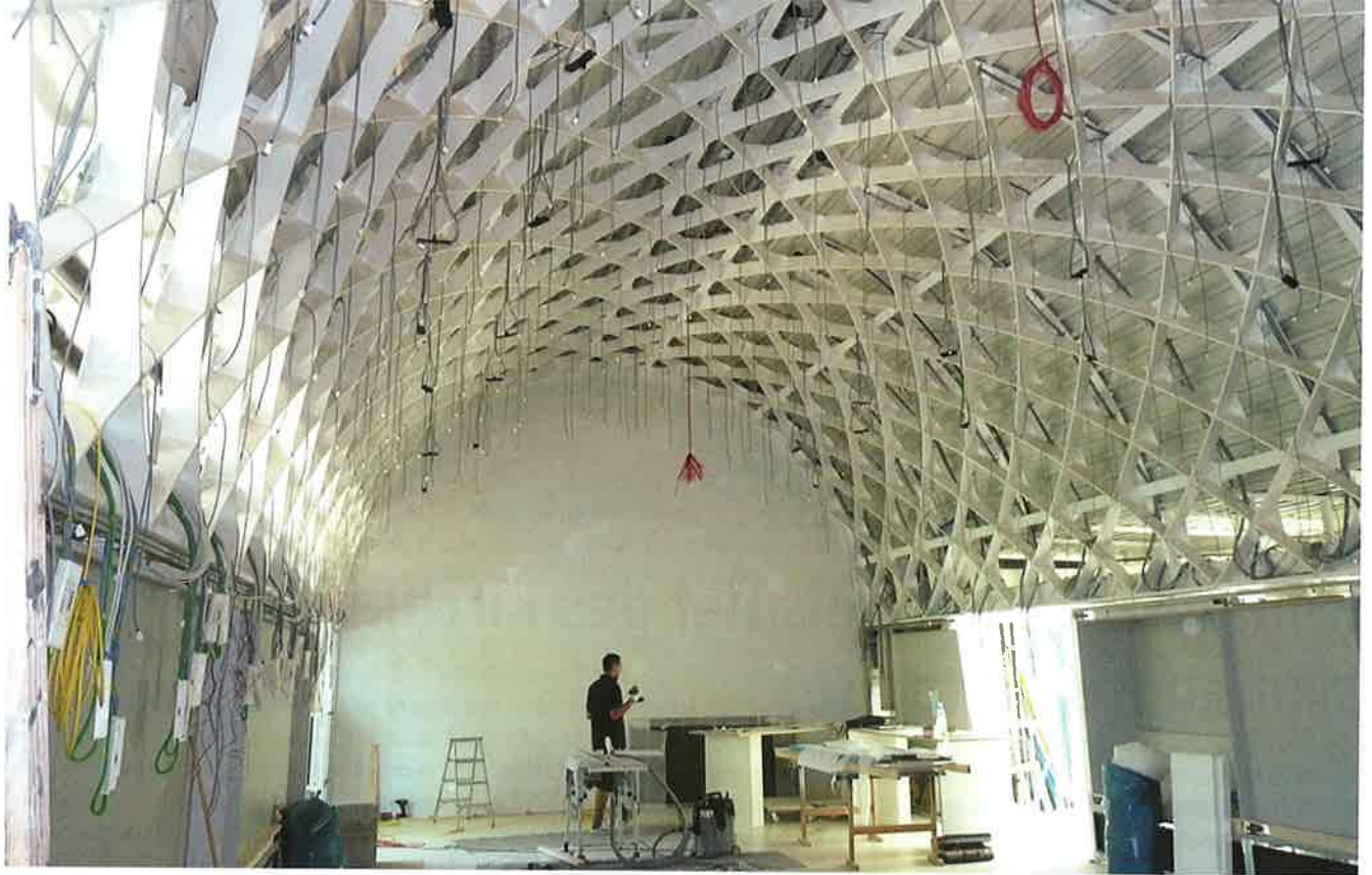
Abb. 4: Die tonnenförmige Stahlkonstruktion prägt den Museumstrakt; die seitlichen Wände des Ausstellungsraumes sind mit freistehenden Vorsatzschalen bekleidet.
