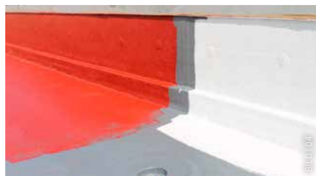
Nachdem die Grundbeschichtung vollständig getrocknet war, konnte die erste Lage der Deckbeschichtung in Schiefergrau aufgetragen werden.
