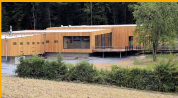
Auf den drei Dachflächen wurde vor der extensiven Begrünung die Kunststoffdachbahn Sarnafil TG 66-20 lose verlegt.
