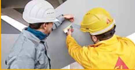
KORROSIONS- UND BRANDSCHUTZ
