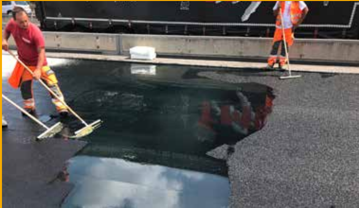
Nach vollständiger Tränkung mit Sika® Ergodur-600 wurde überschüssiges Reaktionsharz mit Gummischiebern verteilt und abgezogen.
