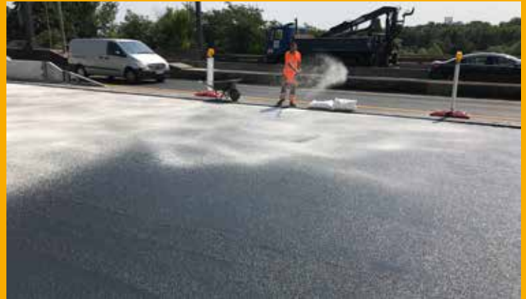
Das Schmelzklebergranulat Sikalastic®-827 HT wurde auf die frisch getränkte HANV-Schicht lose eingestreut und bewirkt einen zuverlässigen Verbund zur nachfolgenden Gussasphaltschicht.
