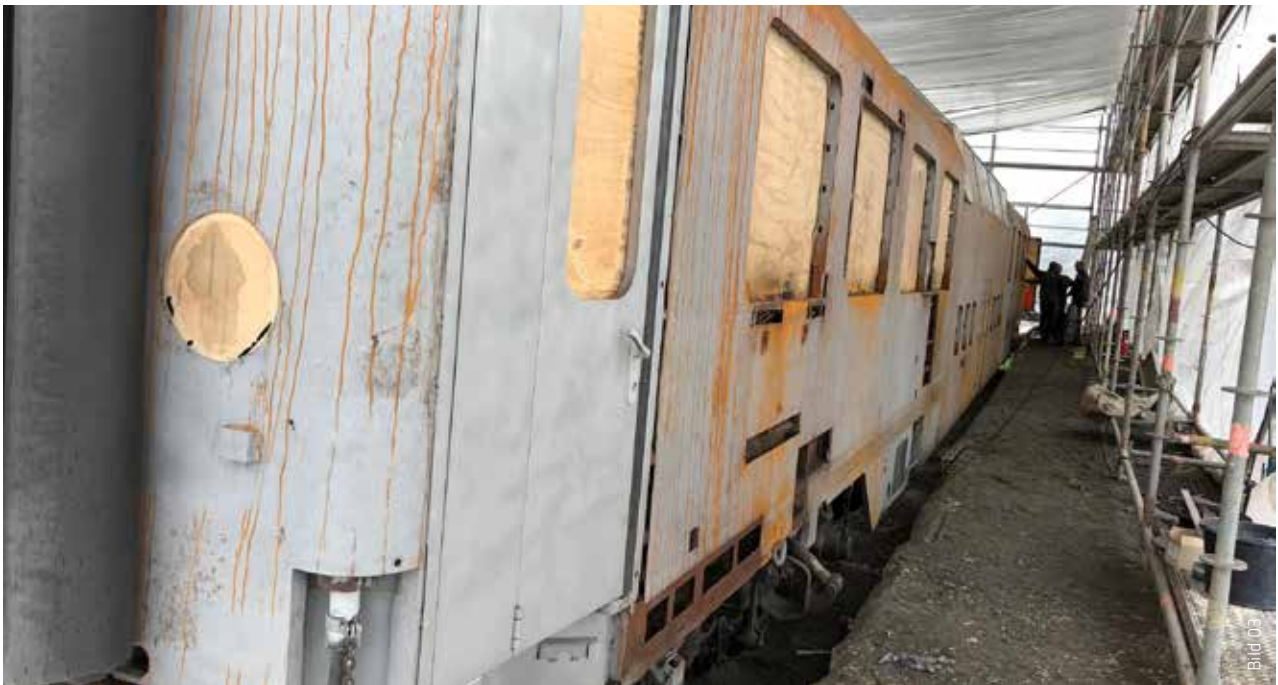
Ziel der Sanierung war die möglichst detailgetreue Aufbereitung des historischen Waggons. Der Waggon war dazu in einer wasser- und staubfreien halboffenen Einhausung untergebracht.
