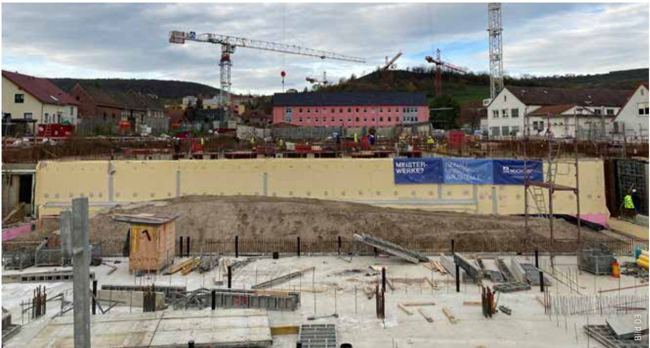
Hier kann man die Dimensionen des Ersatzneubaus vom Friedrich-Loeffler-Institut Jena erahnen: Das Forschungsgebäude wird etwa 40 m breit und 170 m lang sein sowie vier Stockwerke haben. Das Tiefgeschoss wird mit einer WU-Betonkonstruktion und dem SikaProof® A+ Frischbetonverbundsystem zuverlässig geschützt, um die hohen Anforderungen an die Gebäudehülle zuverlässig zu erfüllen.
