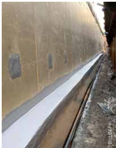
Bodenplattenüberstände, Arbeitsfugen und Detailausbildungen wie Spannstellen wurden mit dem Sikadur-Combiflex® TF System abgedichtet. Das System ist in Kombination mit dem SikaProof® A+ System auf Druckwasserdichtigkeit geprüft.
