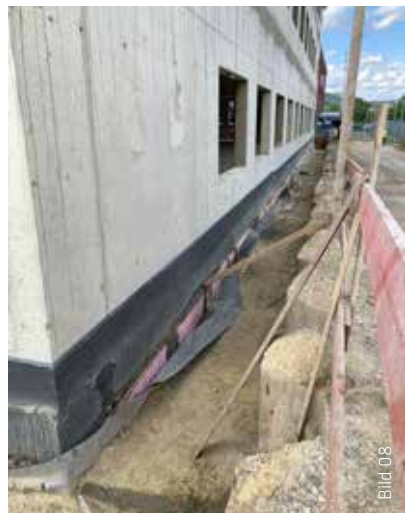
Als Sockelabdichtung kam das SikaTop®-126 Pro zum Einsatz, eine rissüberbrückende flexible polymere Dichtschlämme.
