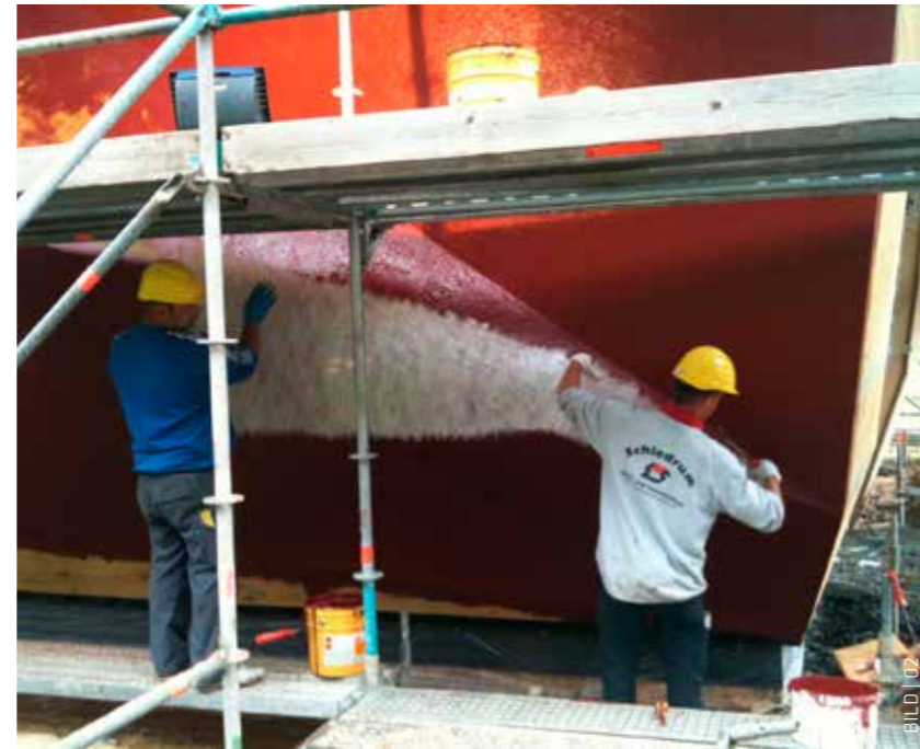
Dank des Sikalastic® Flüssigabdichtungssystems ist es nun auch von allen Seiten sicher abgedichtet.
