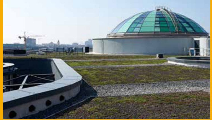
Ein Teil der Dachflächen wurde anschließend an verschiedenen Stellen extensiv begrünt und passt sich hervorragend an die Dachgestaltung an.
