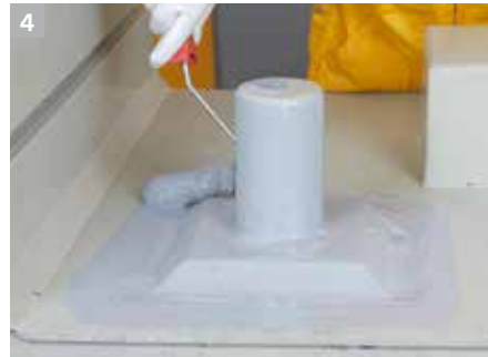
4 Bei der Applizierung der ersten Lage werden etwa 2/3 des Gesamtverbrauches pro m 2 eingesetzt.
