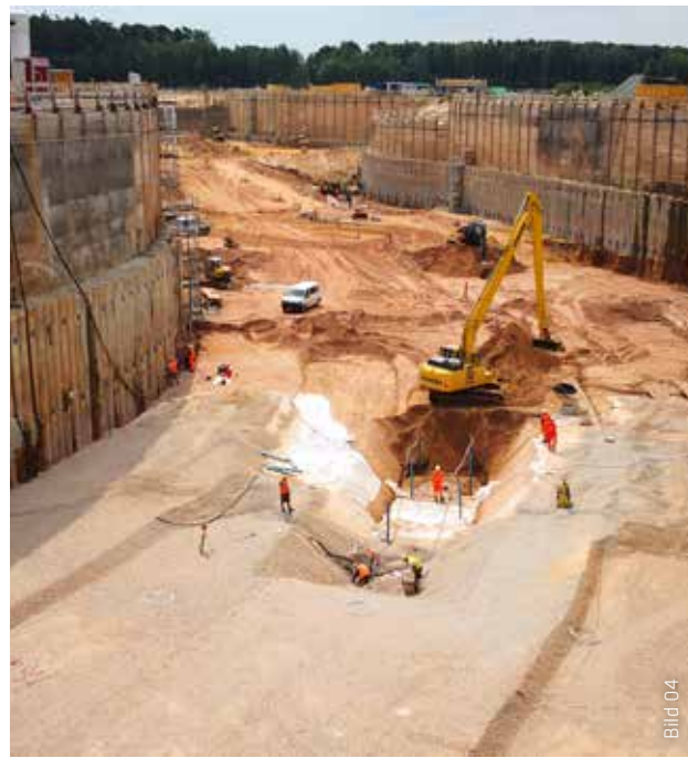
Vorbereitung des Untergrunds im Bereich des Beschleunigertunnels für die Verlegung des Frischbetonverbundsystems.
