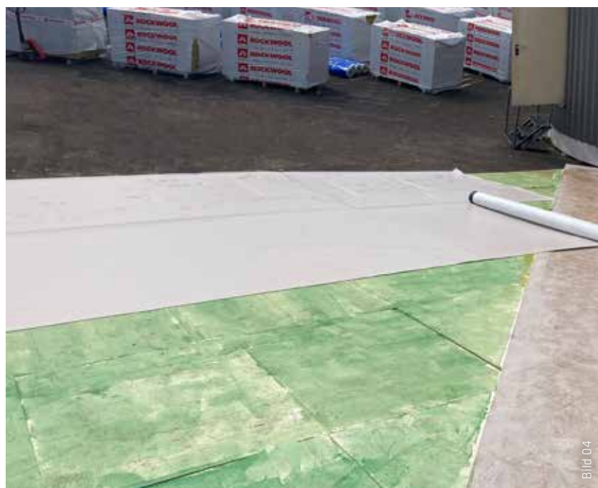
Beim Verlegen wurde eine erste Bahn mit 2 m Breite und 15 m Länge vom Hochpunkt des Daches zum Tiefpunkt verlegt. Die daran anschließenden Bahnen wurden als Dreiecke zugeschnitten und angefügt.
