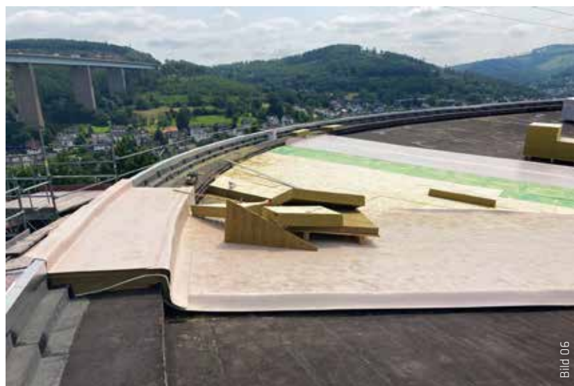
Für die Befestigung am 50 cm erhöhten Dachrand wurden kaschierte Bleche montiert, auf denen die Abdichtungsbahn aufgeschweißt wurde.
