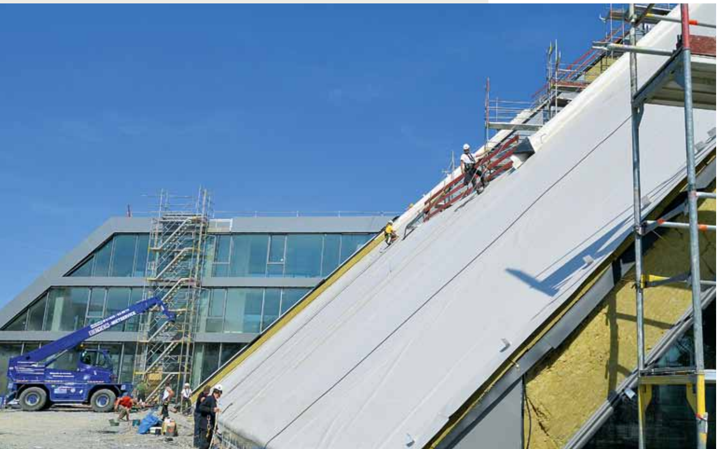
Bei der insgesamt 3.600 m 2 großen Dachfläche wurde auf allen Flächen gedämmt. Als Oberlage verlegten die Dachdecker auf allen 6 Teilflächen eine FPO-Dachbahn.
