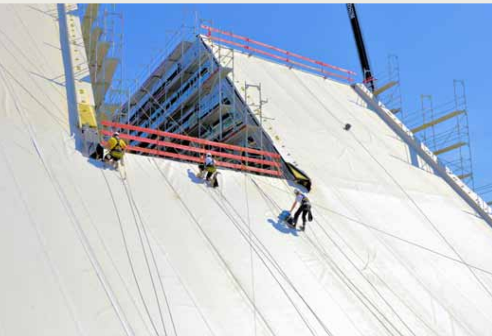
Die Dachdecker mussten alle Arbeiten am 45 Grad steilen Dach angeseilt und mit spezieller Schutzausrüstung ausführen.
