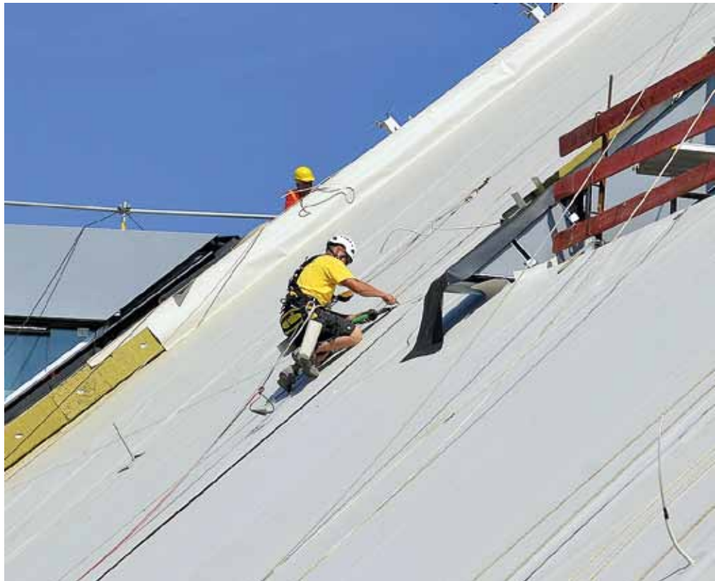
Vor der Verschweißung der Dachbahnen mussten diese ausreichend gesichert werden, damit sie nicht abrutschen konnten. Die Nahtfugung erfolgte dann mittels Heißluft-Handschweißautomaten.
