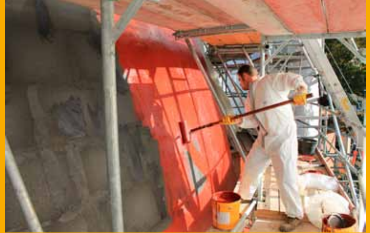
Das verwendete Sikalastic® Flüssigkunststoffsystem geht einen direkten Verbund mit der Wärmedämmung ein und passt sich über die Systemvlieseinlage frei an die Kuppelform an.
