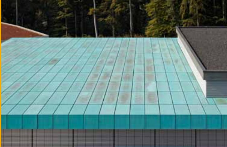
Das Dach des CASINO-Gebäudes, abgedichtet mit Sarnafil® TS 77-20, mit seiner vorpatinierten Kupferverkleidung.
