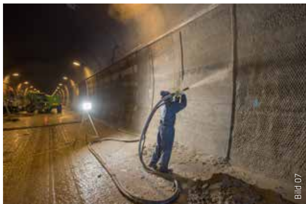
Für die extrem große Förderweite des Spritzmörtels von 400 Metern hat Sika ein spezielles Maschinenkonzept entwickelt.
