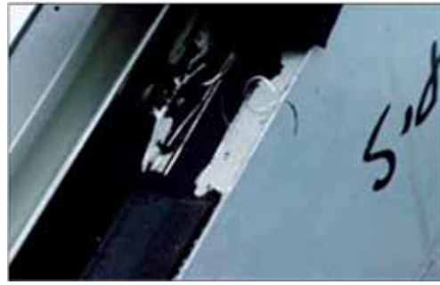
Abbildung 40: Beispiel mit schwarzer SG-Fuge schlechtes Haftergebnis (Haftungsversagen)
