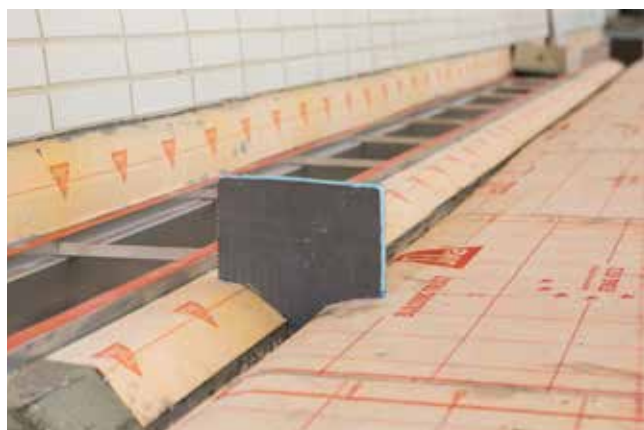
Die neue kapillarbrechende Fuge und die Edelstahlrinne sind mit dem Spezialfugendichtband SCHÖNOX ST 50/ ST 25 und der SCHÖNOX AB Bahn abdichtungstechnisch miteinander verbunden worden. Die Schablone dient zum temporären Begrenzen der Vergussbereiche. Diese wurde später herausgezogen und der Bereich nachvergossen.
