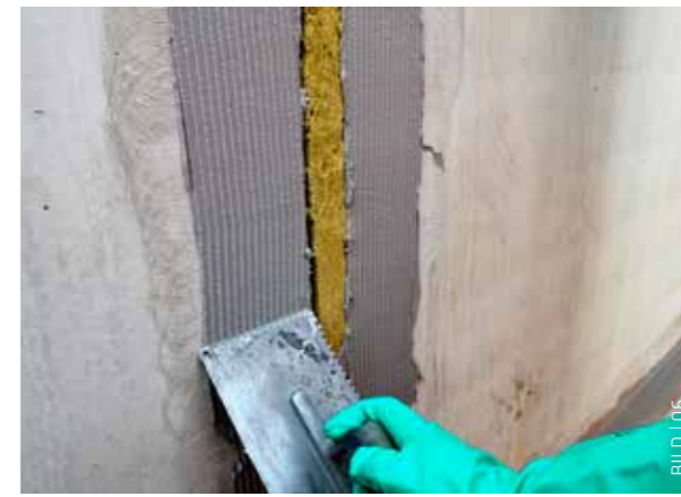
Aufbringen des Klebergrundauftrags bei der Abklebung von Dehnfugen mit dem Sikadur-Combiflex® TF System
