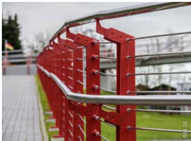
Die rote Deckbeschichtung des Brückengeländers ist mit SikaCor® EG 5 Clearcoat versiegelt und so gegen vorzeitiges Abwittern geschützt.
