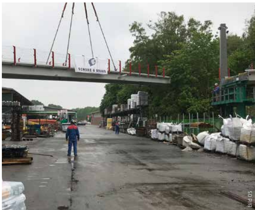
In einer spektakulären Aktion wurden die vormontierten Brückenteile von einem Schwerlastkran in ihre endgültige Position eingehoben.
