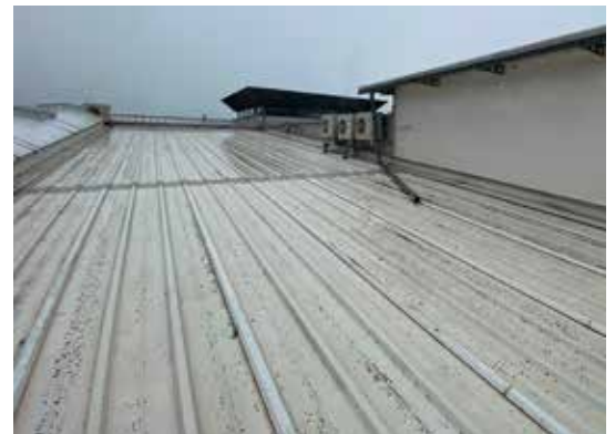
Vorher: Das Dach des Produktionsgebäudes zeigte partiellen Sanierungsbedarf.
