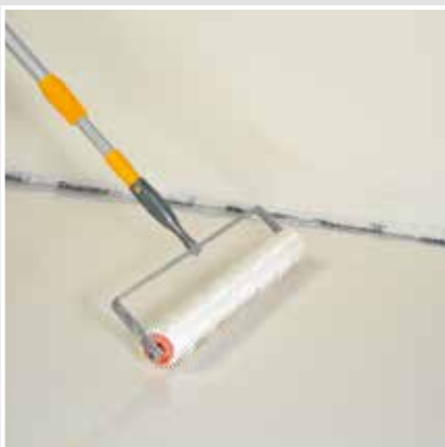
Die Abdichtung mit einer Stachelwalze (Stachellänge ca. 1 cm) abrollen und die Schichtstärke prüfen.
